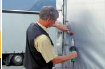
Аппарат ТРИАК PID с щелевой насадкой и прикаточный ролик при ремонте тентового покрытия грузового автомобиля.
